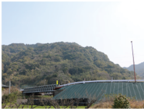
↑平成27年の土砂災害と28年の台風16号で甚大な被害を受けた深港川。磯脇橋は仮橋がかかり、懸命な復旧作業が今も続いています。
