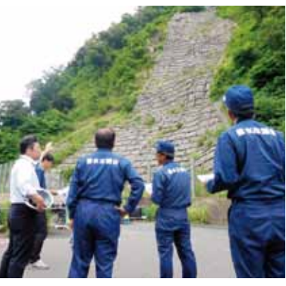
桜島口牛根麓線法面
