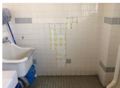
[ タイルの剥離 ]
