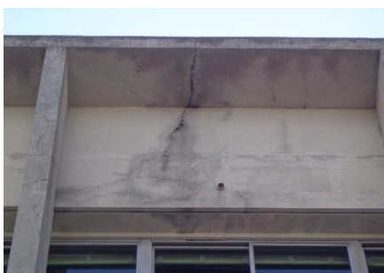
[ 外壁面などに見られるクラック ]
