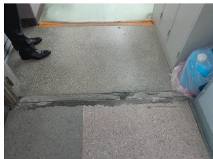
[ エクspansion・ジョイント部分の段差 ]
