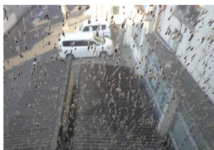
[ 清掃だけでは落ちない降灰跡が残る窓ガラス ]
