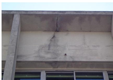
[ 外壁面などに見られるクラック ]
