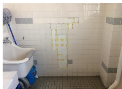
[ タイルの剥離 ]
