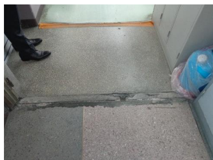
[ エクspansion・ジョイント部分の段差 ]
