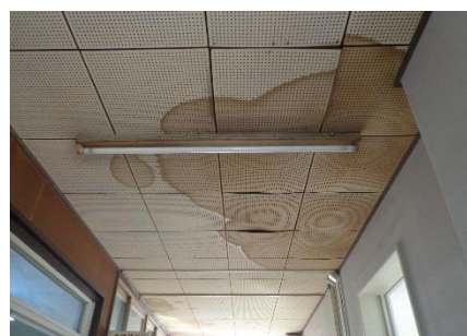
[ 天井の雨漏りによる漏水跡と剥離のおそれ ]
