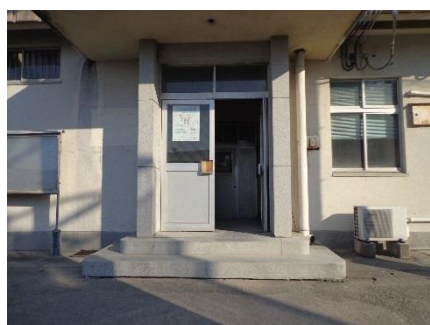
[ スロープが設置されていない出入口 ]
